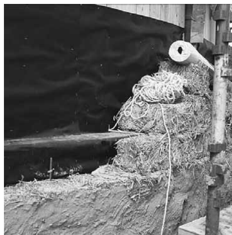
Figur 14. Lerhalmsblocken murades upp runt kyrkorummets stående plank med förhydringspapp emellan. Vissa skift förankrades med rep av sisal. Blockens första lager av grovputs lades på i samband med murningsarbetena. De sprickor som uppstod fylldes igen när det andra lagret grovputs av lera lades på väggen.
