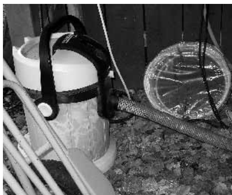
Figur 4:5. En grovdammsugare har byggts om till centraldammsugare och finns i anslutning till teknikboden.
